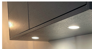
LED spotlights, infällda under väggskåp (2,4 watt)
