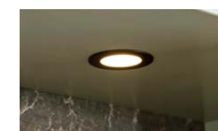
Spotlights Tuve Placering under överskåp
